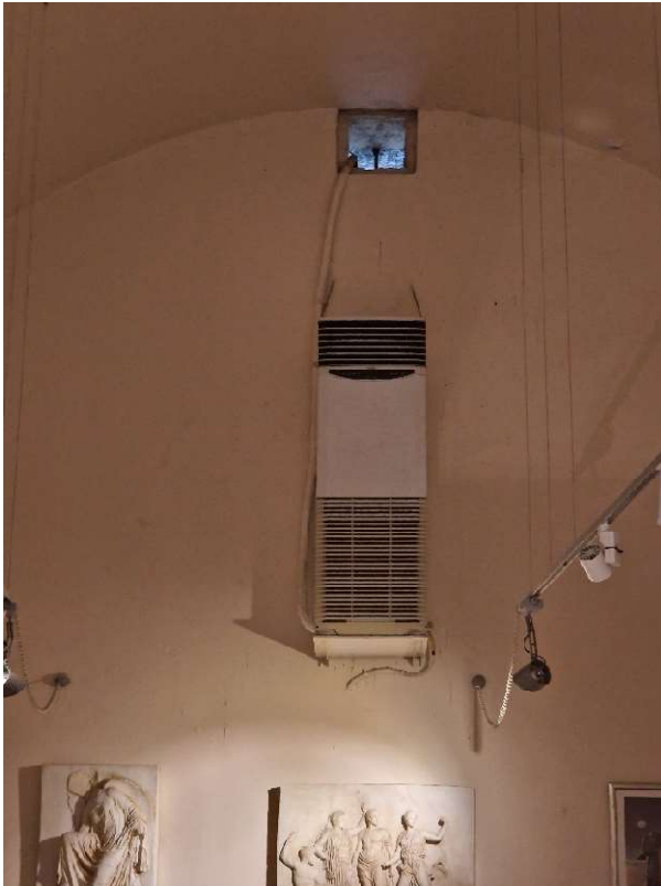
Εικόνα 10. ΤΟ ΥΦΙΣΤΑΜΕΝΟ ΚΛΙΜΑΤΙΣΤΙΚΟ ΤΟΥ ΠΩΛΗΤΗΡΙΟΥ
